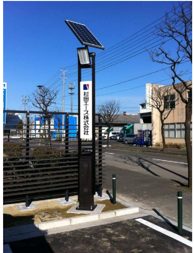
車を照らすLED照明灯。ソーラーで発電
