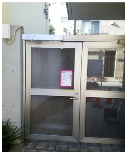
自動ドアモード マンション駐輪場通用口
